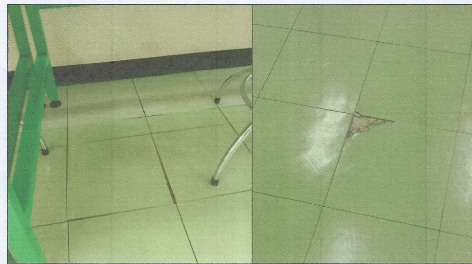
F.2 กระเบื้องยาง ลักษณะกระเบื้องยางที่เสียหาย ขนาด-หลุดร่อน -กำหนดให้ เปลี่ยนกระเบื้องยางตามแบบ FLOOR PATTERN PLAN หรือแผนที่เสียหายที่ในแบบมีที่กำหนดให้
